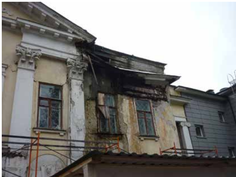
Илл. 20. Фрагмент северного фасада. Видны следы гниения и разрушения бревен несущей стены
