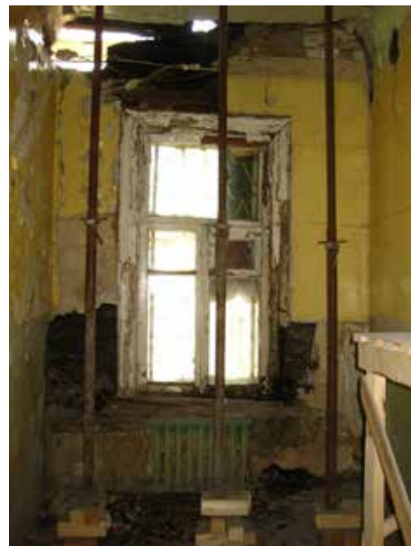
Илл. 21. Следы гниения и разрушения бревен внутри помещения
